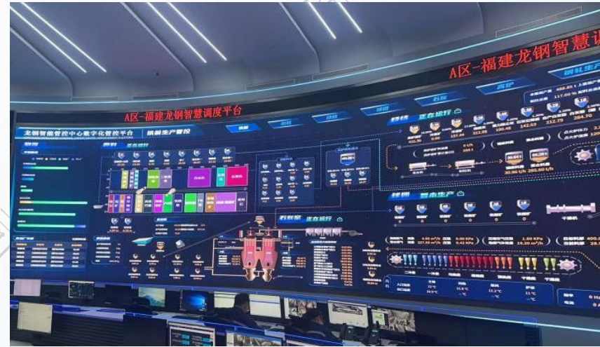
福建龙钢智慧能源管理平台
